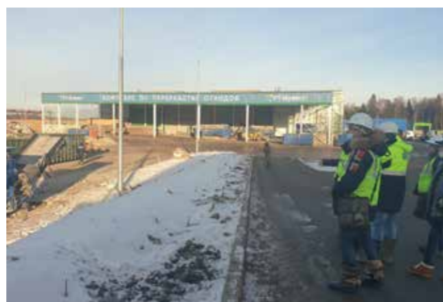
Общий вид комплекса по переработке отходов
