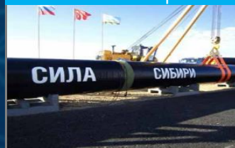
Магистральный газопровод «Сила-Сибирь»
